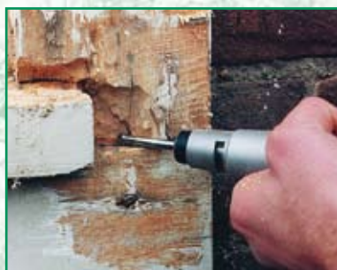
verwijderen van te zacht, verweerd, aangetast hout
