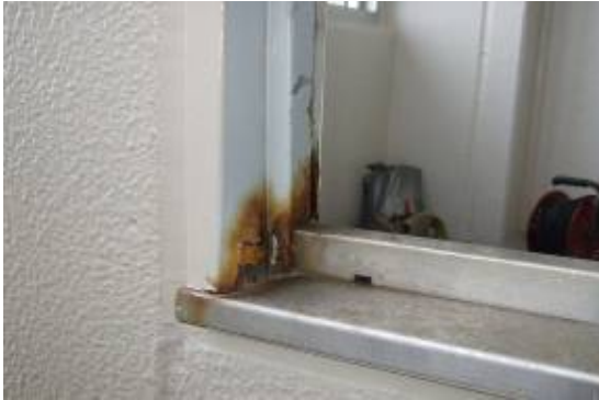
①ドア戸当り付近に腐食あり
