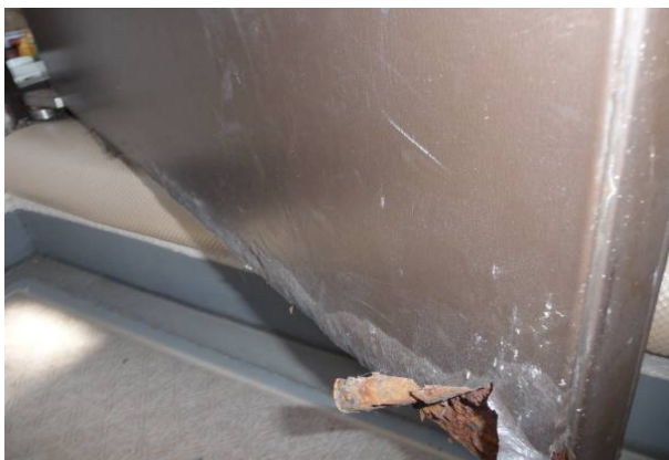
鉄扉の腐食拡大図
