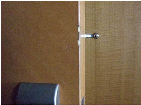
客室ドアに欠損が発生。
